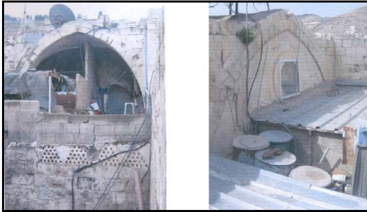
شكل رقم (6.25) إضافات عشوائية فوق أسطح المنازل تعمل على تشويه المباني
